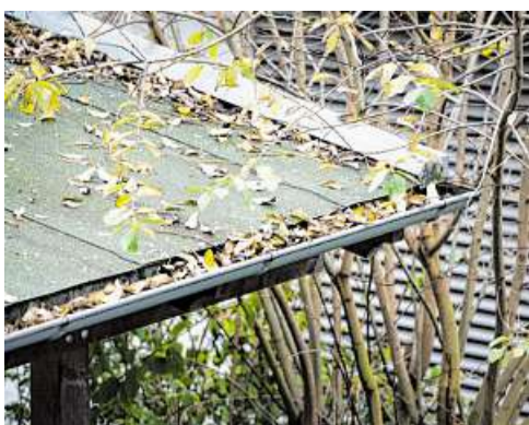
Die Dachrinne voller Laub sowie Risse in der Fassade – zwei Dinge, die Hauseigentümer ernst nehmen sollten.
